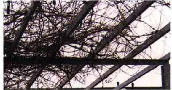
Pergola aus Stahl
