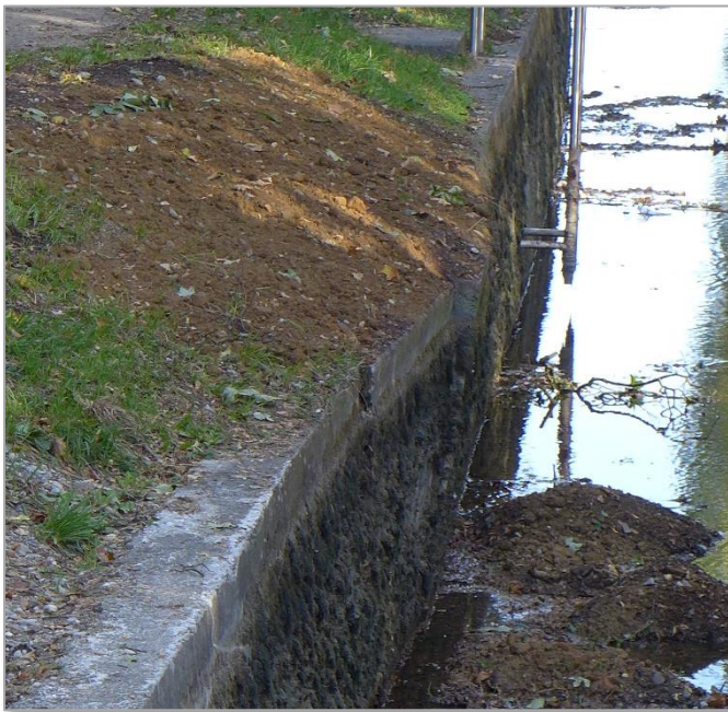
Abb. 4 Schäden an der Betoneinfassung nördlich Heinebrücke
