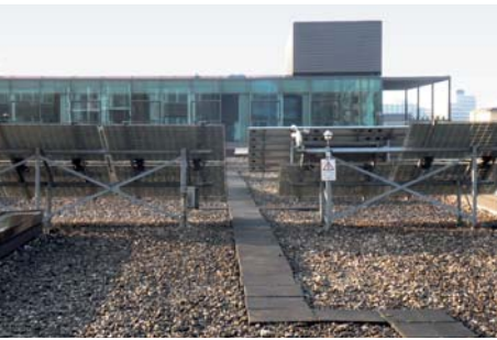
Solarpanels auf dem Dach
